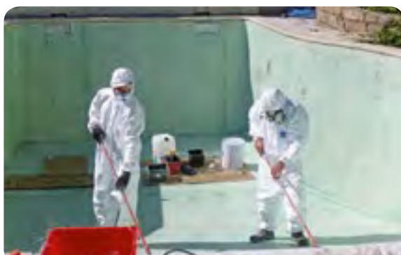
Imprégnation au rouleau de la résine catalysée après la pose d'un mat de verre 450 g
